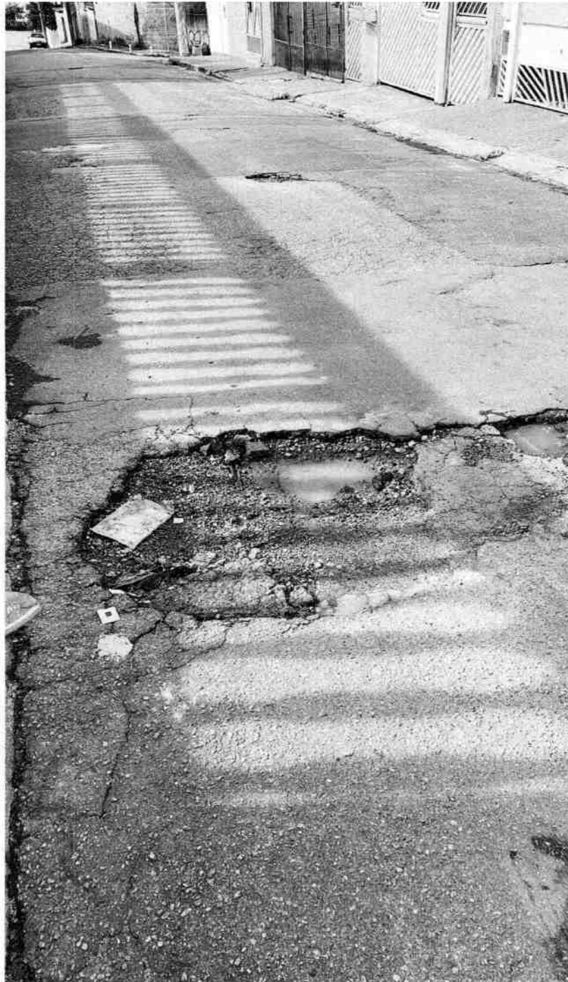
TAPA-BURACO EM TODA EXTENSÃO DA RUA ARARA, VILA CINTRA – MOGI DAS CRUZES.
